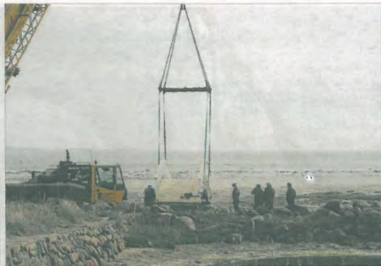
Niels Helledie fra Østervrå havde gang i en af de store kraner, da den næsten to ton tunge bro fredag blev løftet på plads ud for Skansehavnen. Broen går over den nye sejltrede, som løber mod nord.
